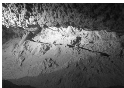
图7 岩锚梁纵向裂缝影像图
