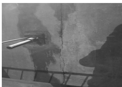
图6 岩锚梁横向裂缝影像图
