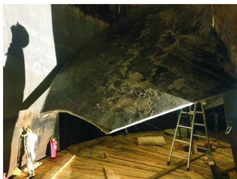
图5 1号机1号叶片出水边脱落图
