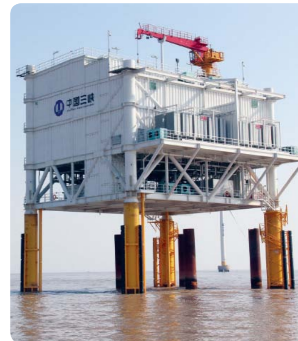
江苏响水 20 万千瓦近海风电项目升压站
