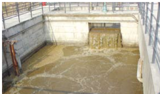
溪洛渡水电站生活污水处理设施运行
