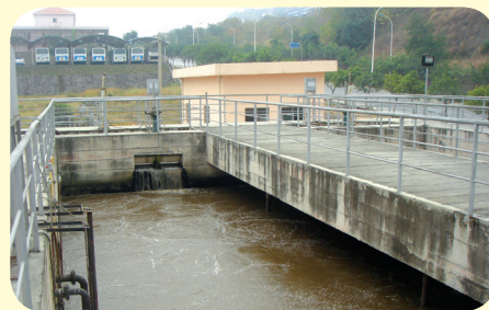
溪洛渡污水处理设施
