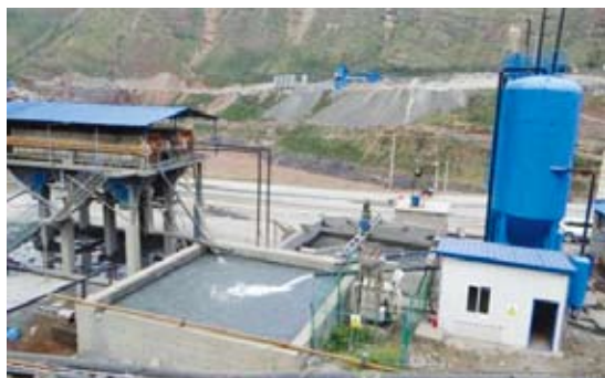
白鹤滩新建村砂石废水处理系统
