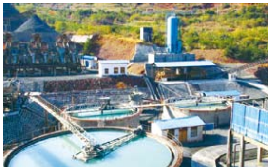
溪洛渡塘房坪废水处理系统
