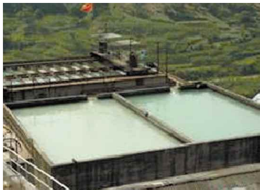
三峡工程施工区下岸溪生产废水回收系统
